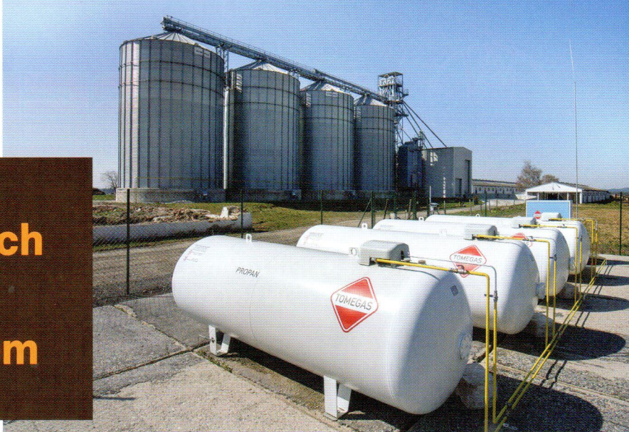
Obr.: Ke skladování propanu slouží 4 zásobníky o objemu 4,2 m 3
