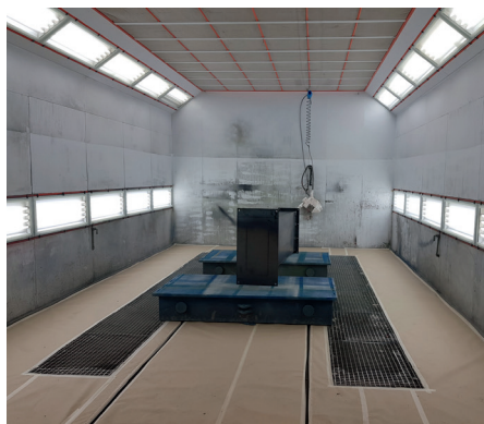
LAKOVNY A PROPAN. Tuzemské firmy často používají pro vytápění a sušení lakovaných produktů kapalným propanem.
